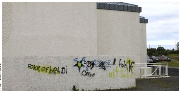
Sóðalegt veggjakrot á suðurhlíð kirkjunnar sem snýr að Víðistaðaskóla.
